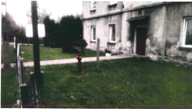
Foto 8. Widok hydrantu zewnętrznego nadziemnego DN 80 Elewacja
